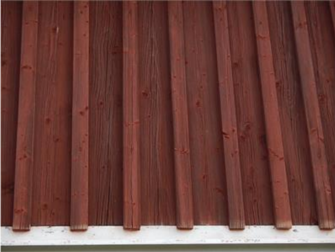
Fasadpanelen har underhållsbehov.
