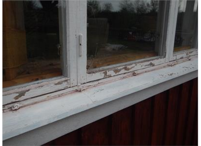
Fönster har underhållsbehov.
