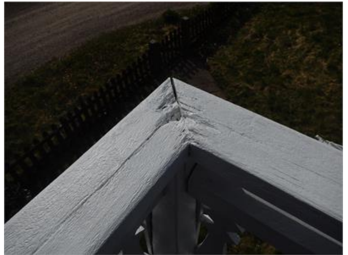
Rötskador i balkongräcket.
