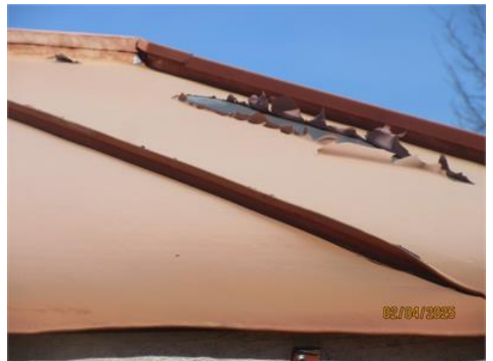
Färgsläpp på plåttak.
