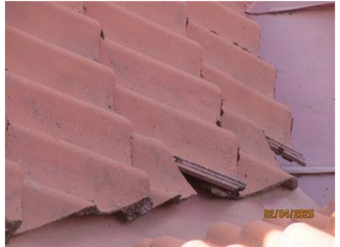
Någon skadad takpanna.
