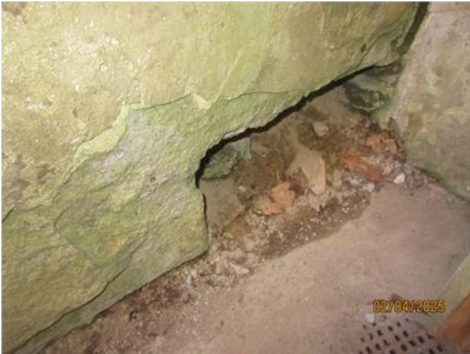
Skador på stödmur till källartrapp.
