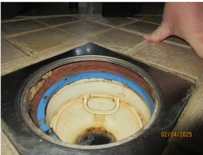
Felmonterad klämmring i golvbrunnen vilket bör kontrolleras/åtgärdas av fackman.
