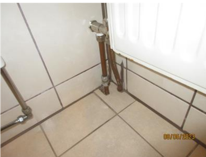
Rör i golv.
