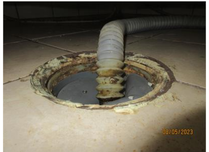
Ej fackmässigt utförd installation av golvbrunn/tätskiktsanslutning, ökad risk för fuktskador föreligger.
