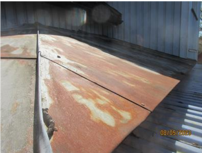
Äldre plåttak i underhållsbehov alt bytes.
