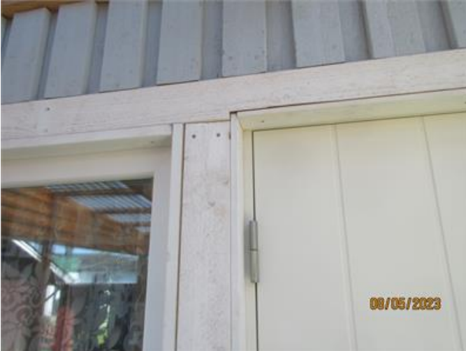
Brister finns i utförandet av foder kring fönster och dörrar.
