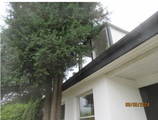
Växtlighet mot byggnaden.
