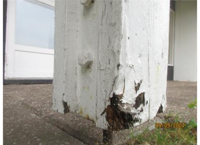
Skador på stolpar till takutsprång förekommer
