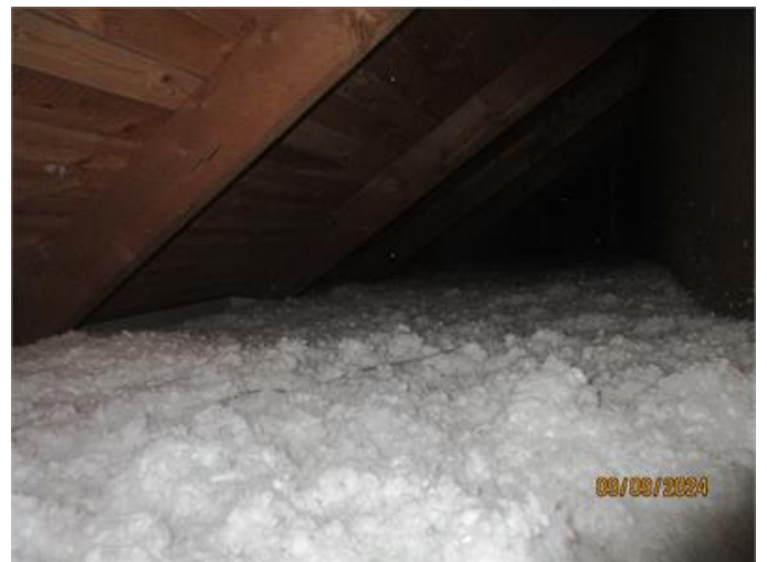
Vindarna endast besiktningsbara från luckor då landgångar saknas över lösullsisoleringen.
