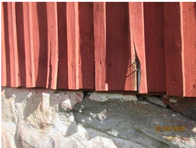
Skador förekommer på fasad.
